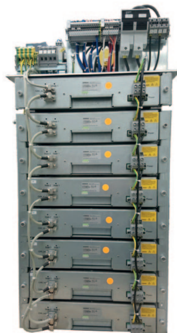
Supercaps moeten voor een bedrijf bijdragen aan peak shaving, aangezien netbeheerders hun klanten afrekenen op de hoogste piek in het eigen verbruik. Foto: Siemens
